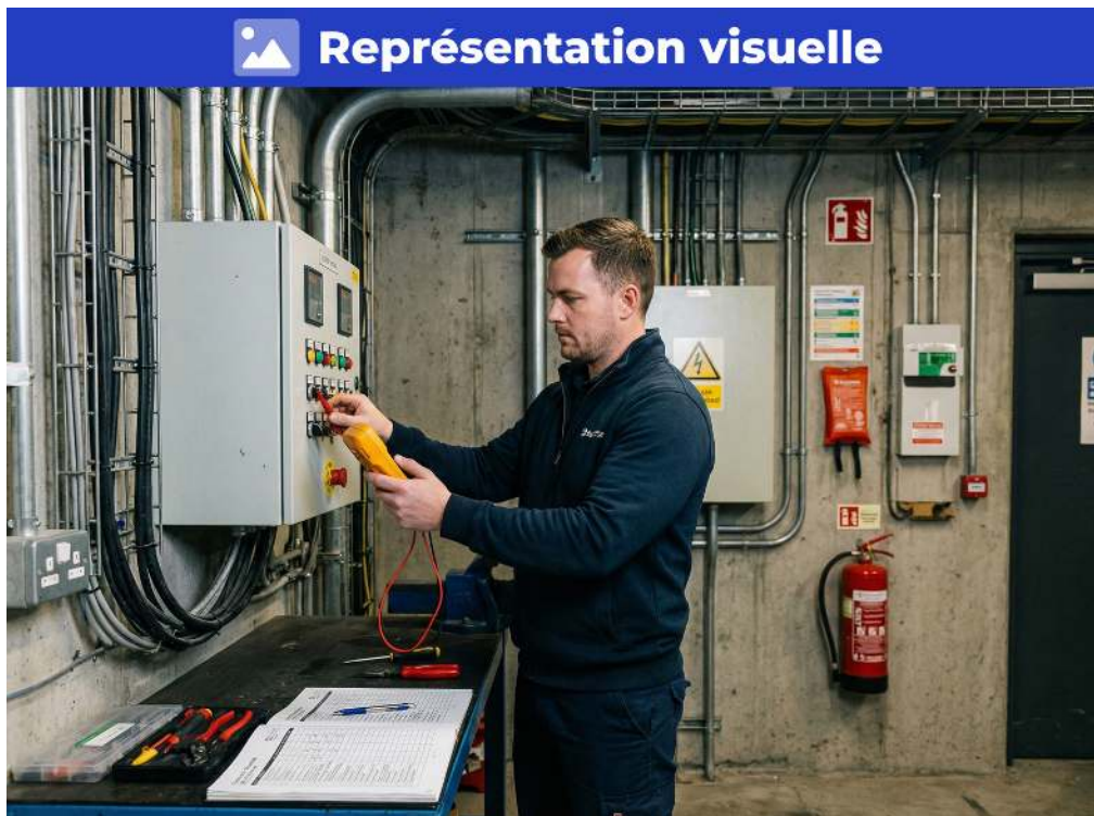
Vérification d'alarme: utiliser un multimètre pour mesurer la tension en volts avant intervention
